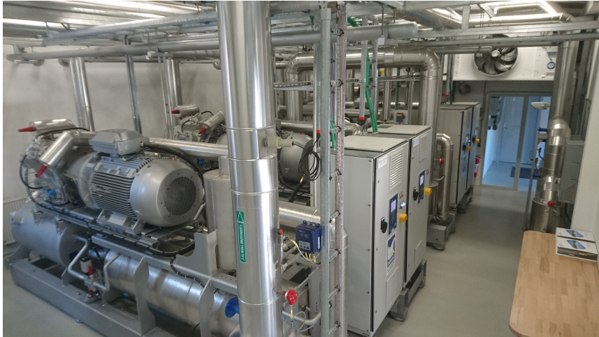
Figur 5.4 – Varmepumpeanlægget i Rødkærsgade, Til venstre ses de to kompressorer oven på tilhørende varmevekslere, som udgør den ene DualPac. I baggrunden anes den anden DualPac, som er opbygget tilsvarende.
