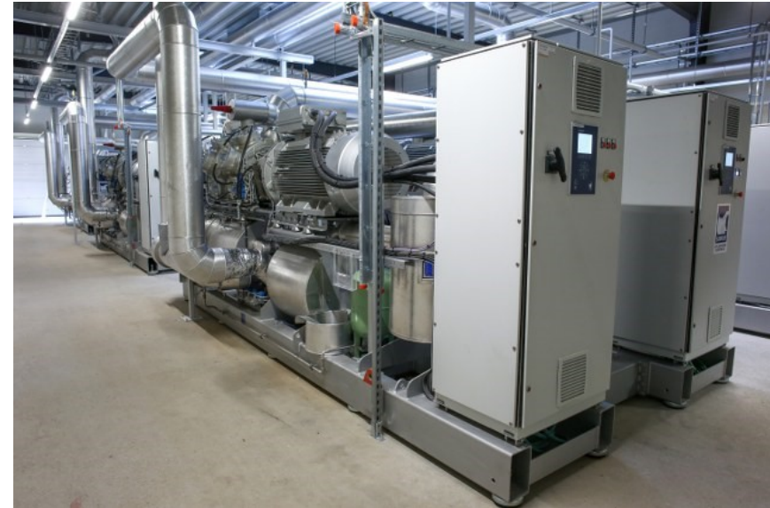
Figur 5.8 – Varmepumpeanlægget i Kalundborg, Enheden forrest på billedet med de to elskabe, udgør den ene halvdel af et “varmepumpesæt”. Det samlede anlæg består af i alt seks lignende enheder.
