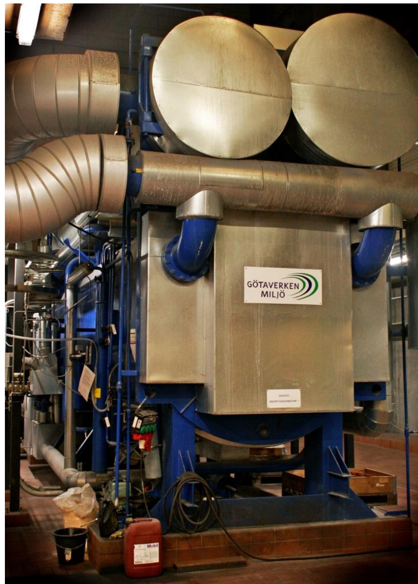
Figur 2.10 – Absorptionsvarmepumpe ved Vestforbrænding.
