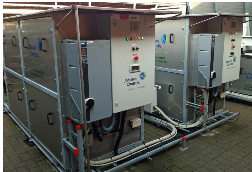
Figur 7.5 – Varmepumper til kombineret varme- og kuldeproduktion på Skejby Sygehus. Kilde: Teknologisk Institut.
