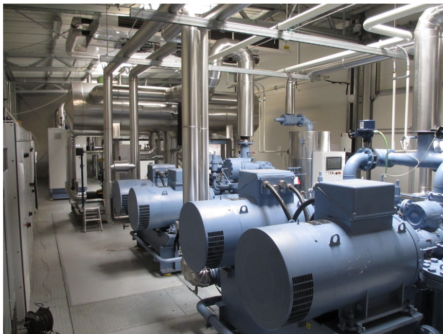
Figur 3.7 – Varmepumpeanlægget i energicentralen. Kilde: Høje Taastrup Fjernvarme A.m.b.a.
