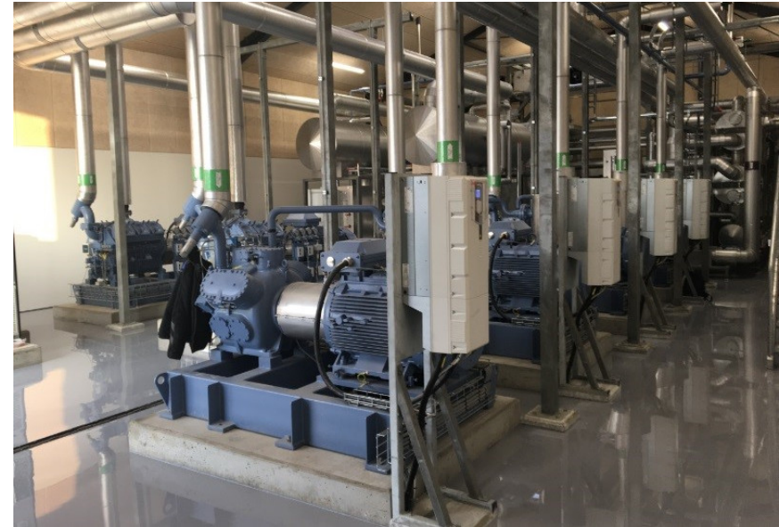
Figur 6.8 – Grundvandsvarmepumpe i Broager.
