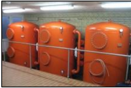
Figur 5.9: Tankanlæg til sandfilteranlæg
