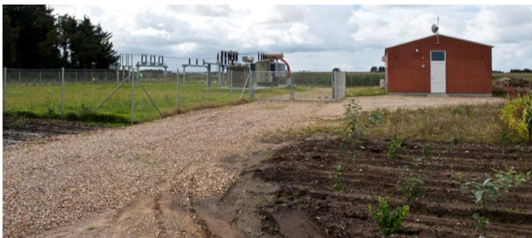
Figur 5.16: Nyanlagt transformatorstation ved 30 MW vindmøllepark. Koblingsstationen ved Velling Mærsk vil være uden transformator, som her ses til venstre for bygningen. Det skyldes, at der vil være samme spænding på de indgående og de udgående jordkabler.
