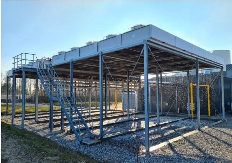
Figure 6. Example of flatbed evaporators at Præstø Fjernvarme.
