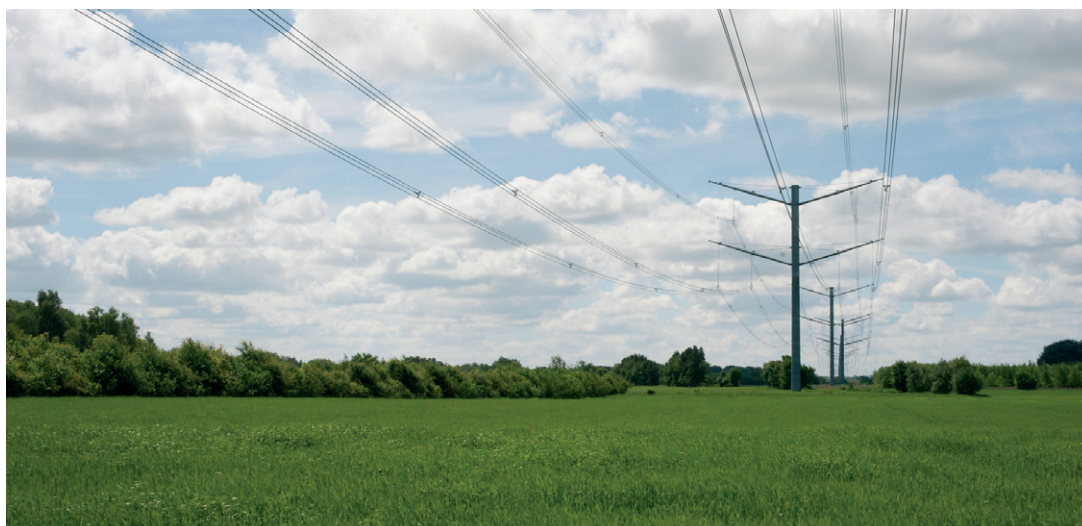
Figur 8.15: 400 kV - forbindelsen mellem Kassø og Tjele, der passerer 4,4 kilometer øst for vindmølleområdet.
