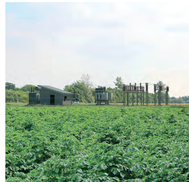
Foto 3.1 Eksempel på en 60/10 kV station med tilhørende teknikbygning på 50 m 2
