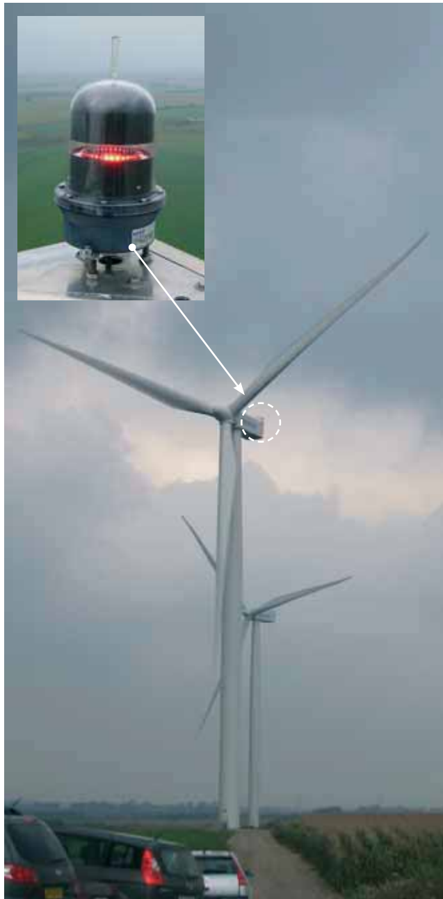
Foto 5.9 Lysafmærkning på Brorstrupvindmølle. Fotoet viser lysafmærkning for fysikkerhed samt placering af lysafmærkning på møllehuset.
