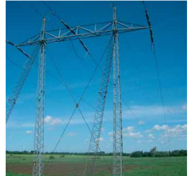
Foto 4.3 - Eksisterende 150 kV luftledning ved Østerbæk.
