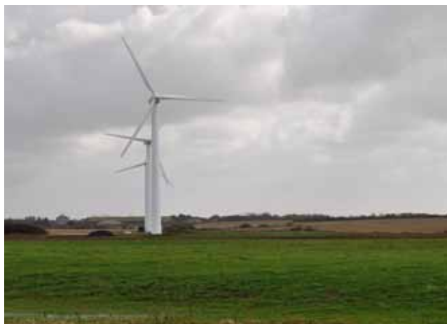
Foto 1.2 Eksisterende vindmøller på Volder Mark.
