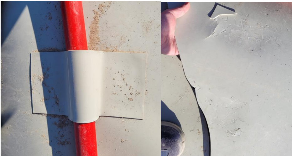
Figur 18: PP strop fæstnet til PP-liner og revne i PP-liner.
