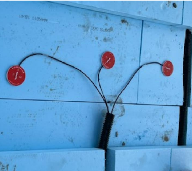
Figur 24: Placering af Hukseflux varme flux-målere i isoleringen (set fra oven).
